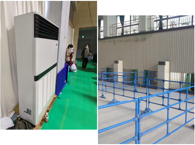
暑熱対策として、屋内の競技会場や選手控室には仮設空調が設置されていた。（左：ハンドボール競技会場（霧島市）、右：水泳競技選手控室（鹿児島市））
